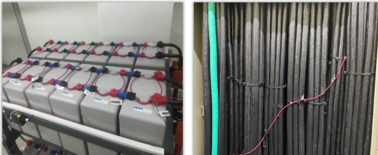
图 四- 1 机房电池组及电缆竖井布纤
