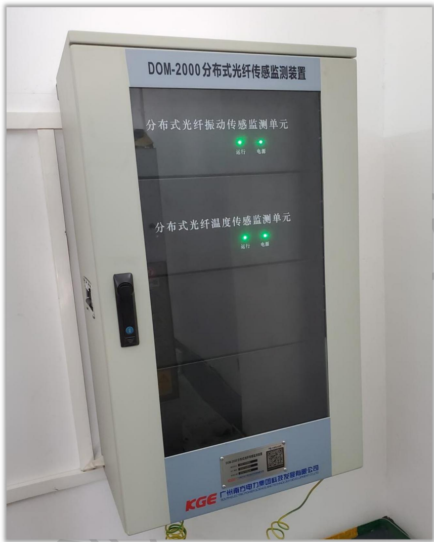
图 四- 5 南方电网电缆综合监控设备
